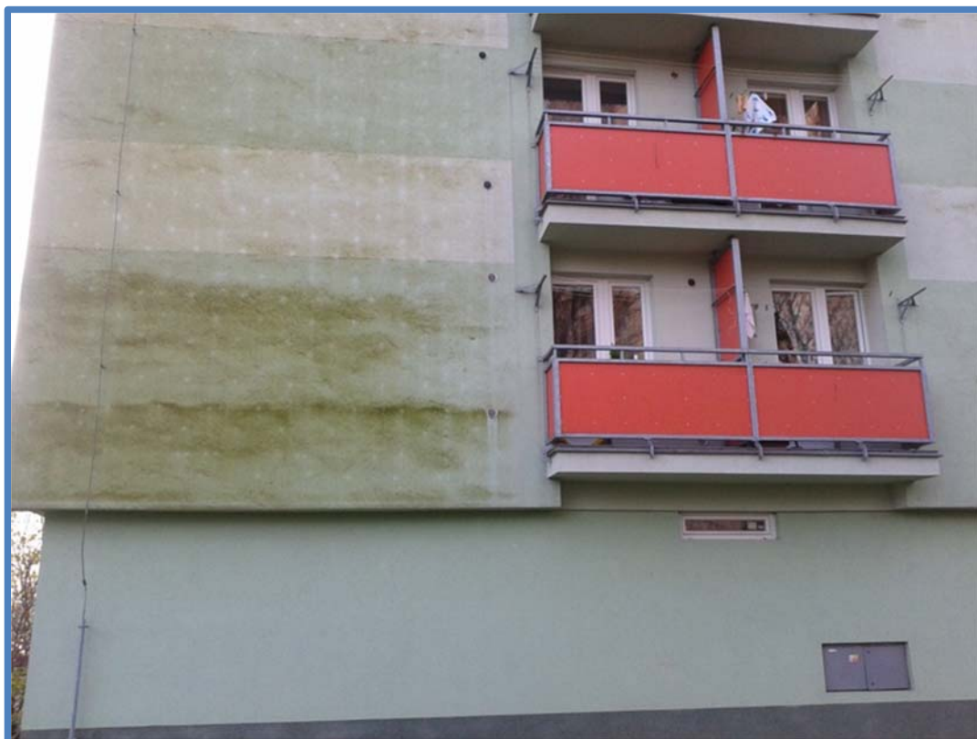
Obr. 1: Příklad výskytu biotického porostu na zateplené fasádě
